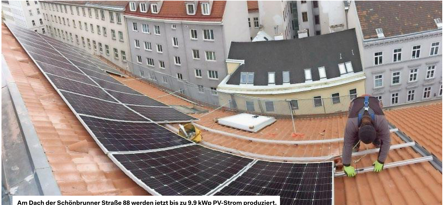
Am Dach der Schönbrunner Straße 88 werden jetzt bis zu 9,9 kWp PV-Strom produziert.
